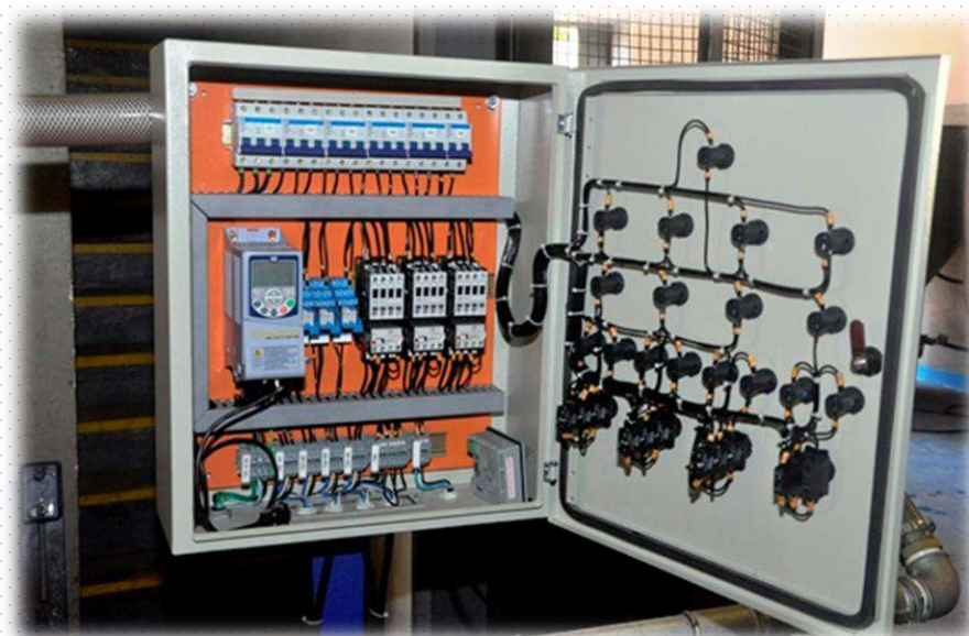
Painel de Automação
